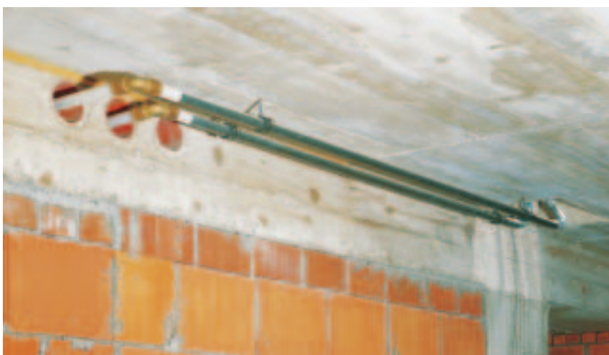
132. ábra: Pincei vezetékek RAUHIS csövekkel
