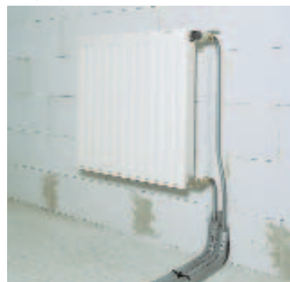
160. ábra: Közvetlen csatlakozás a fűtőtest-szelepekhez
