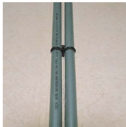
1.3.9. ábra: Padlóra fektetett csővezetékek
