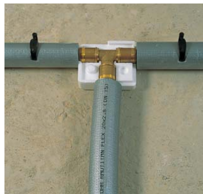
1.3.7. ábra: Padlóra fektetett T-idom REHAU hangszigetelő dobozban
